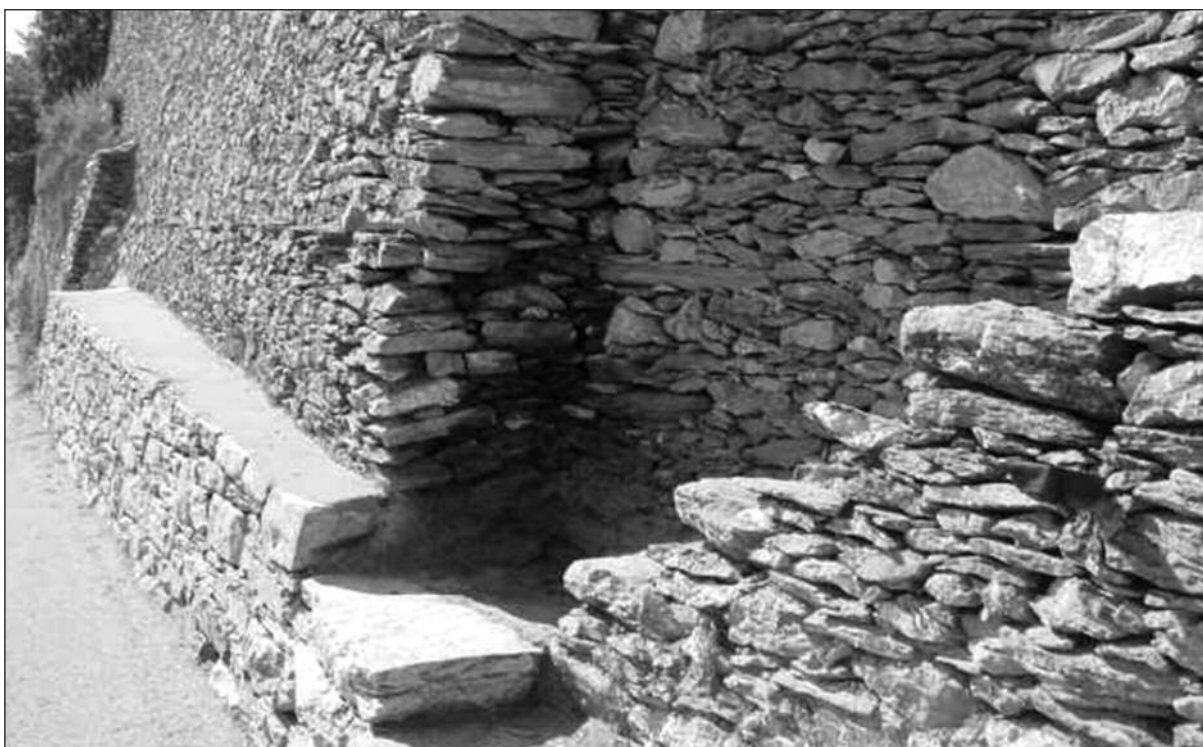
Les différents types de murs en pierres sèches. Verschiedene Arten von Trockenmauern.
