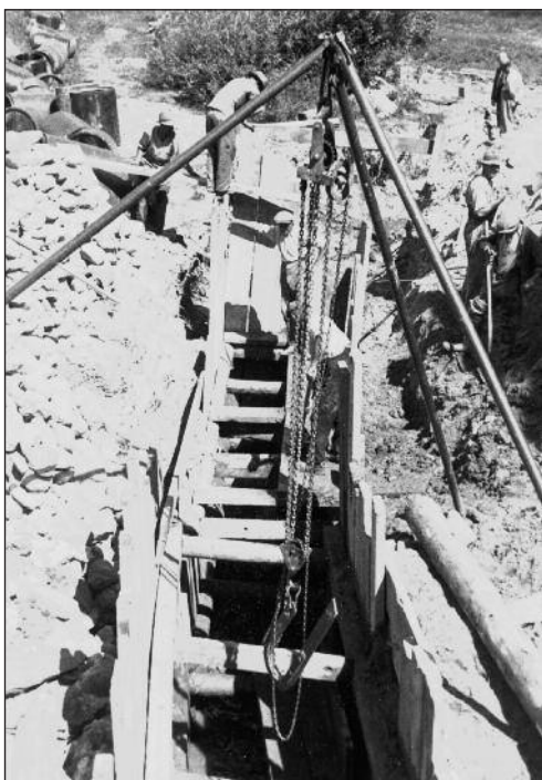
Construction de la canalisation pour l'irrigation du vignoble de Chamoson. Bau der Bewässerungs-Kanalisation im Rebberg von Chamoson.
