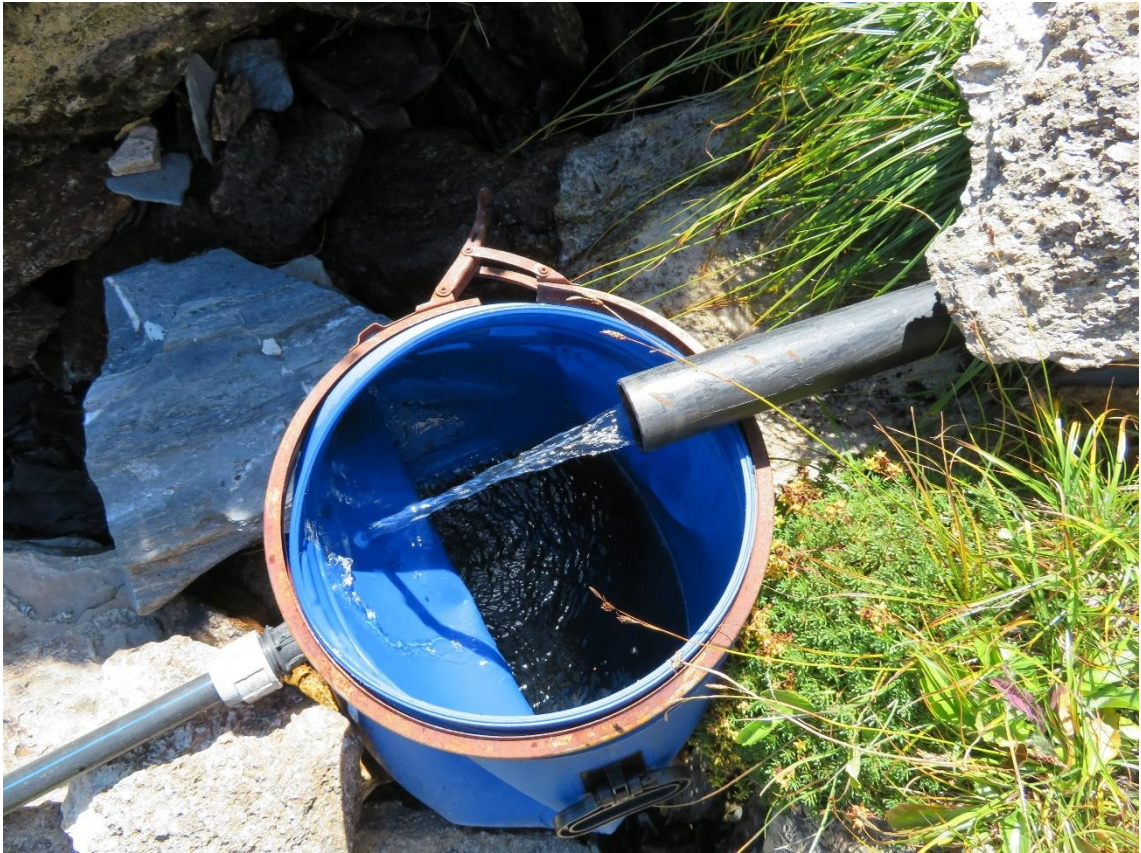
Figure 8: Une des deux prises d'eaux d'abreuvement en rive gauche, celle au Nord. On peut voir les dégâts de l'hiver (écrasement du tonneau en plastique bleu, qui sert de chambre de mise en charge) [12]. Photo prise le 09.09.2020.
