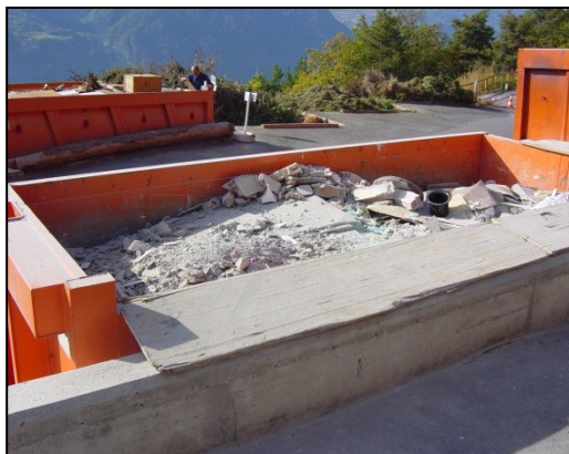
Abb. 4: Mulde für mineralische Bauabfälle
