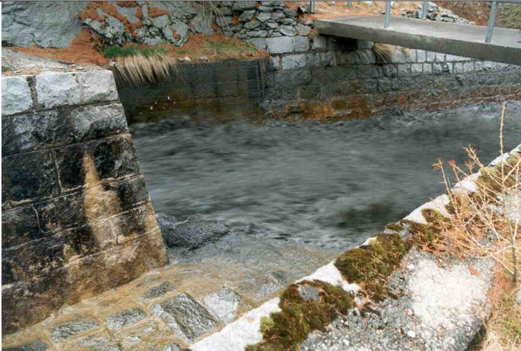
Purge à l'aval du bassin de compensation des Esserts
