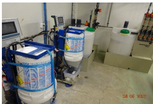
14 : Desinfektionssystem mit Kalziumhypochlorit © DVSV
