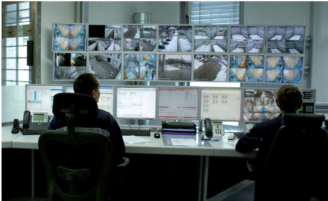
Prison des Iles à Sion: les différents dispositifs de sécurité conçus il y a vingt ans ont été modernisés Gefängnis Sitten: Die vor zwanzig Jahren eingeführten Sicherheitsdispositive wurden modernisiert
